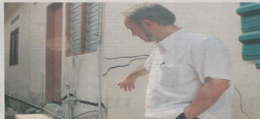
SEORANG penduduk menunjukkan sebuah rumah di Kampung Pindah, Kampung Baru, Kuala Lumpur yang retak ekoran tanah mendap sejak tiga tahun lalu. - UTUSAN/AMARUL RIZAL
